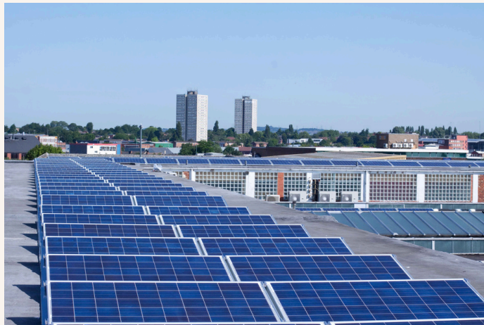
Instalación fotovoltaica. Fuente: Canva
