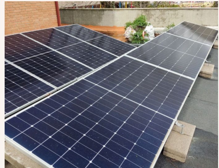
Instalación fotovoltaica CEIP Javier de Miguel (Madrid)
